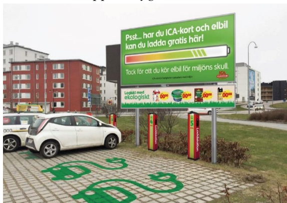
Exempel på laddstation för elbilar. (ICA Fastigheter AB)
